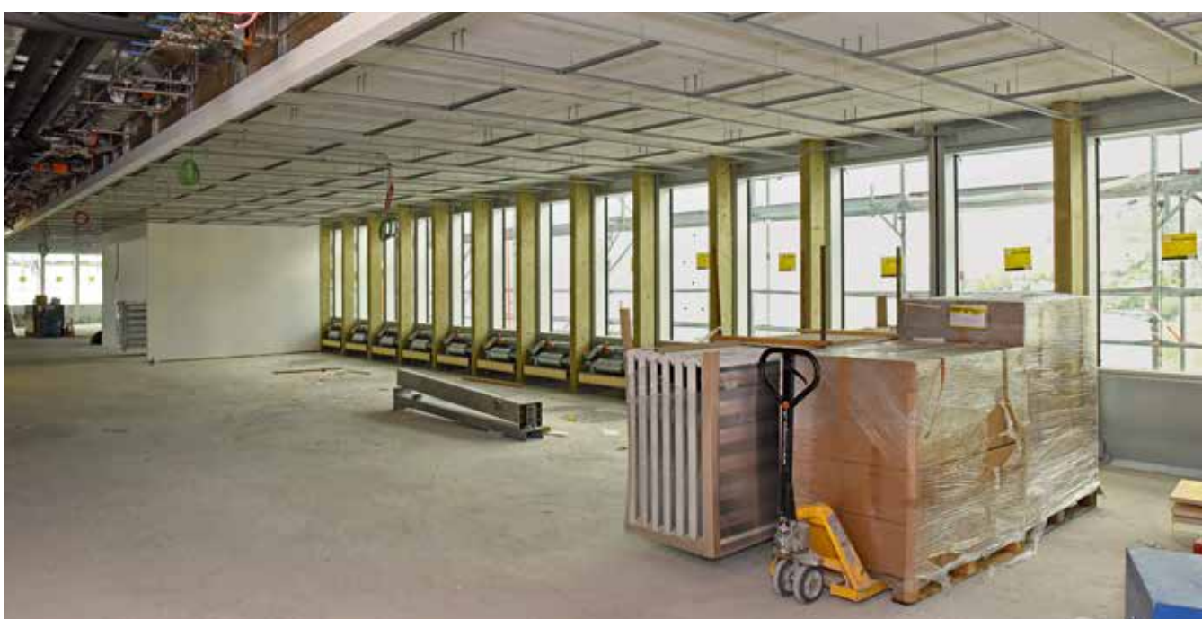
Les façades du bâtiment B représentent une surface totale de 10 000 m 2 . Les verres électrochromes sont actuellement en test (photo du haut). Dans les caissons des vitrages, se trouve la technique de ventilation-pulsion (photo du bas).
